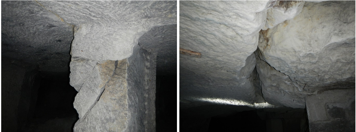
Figure 11 : Secteur nord de la grande carrière des Richarderies, présentant des signes de dégradation
