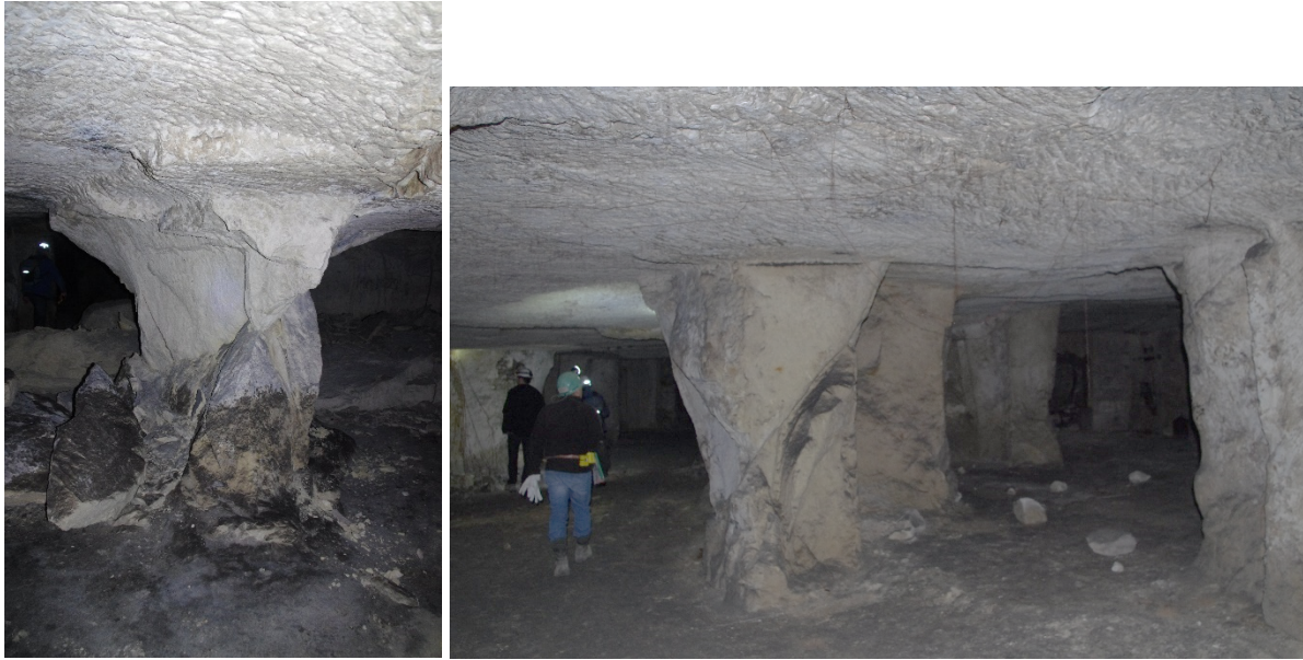
Figure 23 : Exemples de dégradation de pilier
