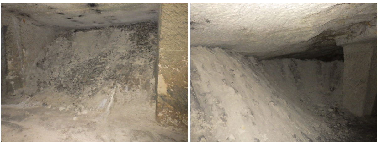
Figure 13 : Vue des remblais empêchant l'accès
