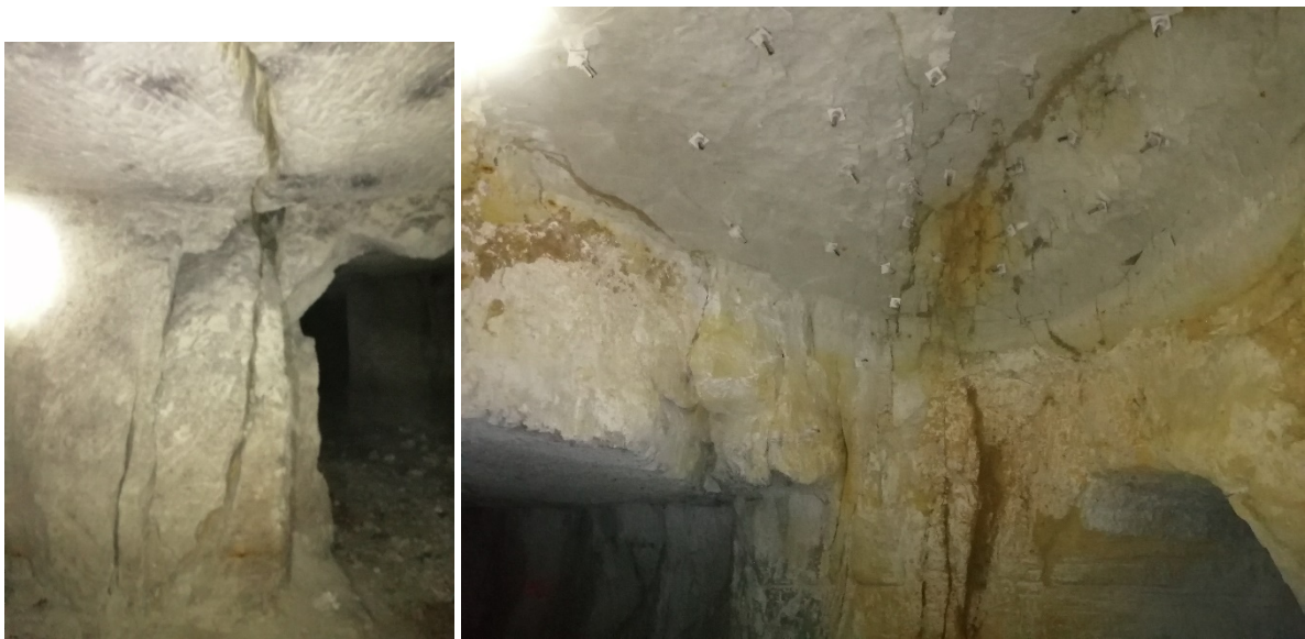
Figure 12 : Secteur nord de la grande carrière des Richarderies, présentant des signes de dégradation
