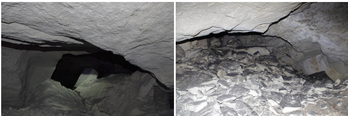
Figure 22 : Exemples de dégradation de toit
